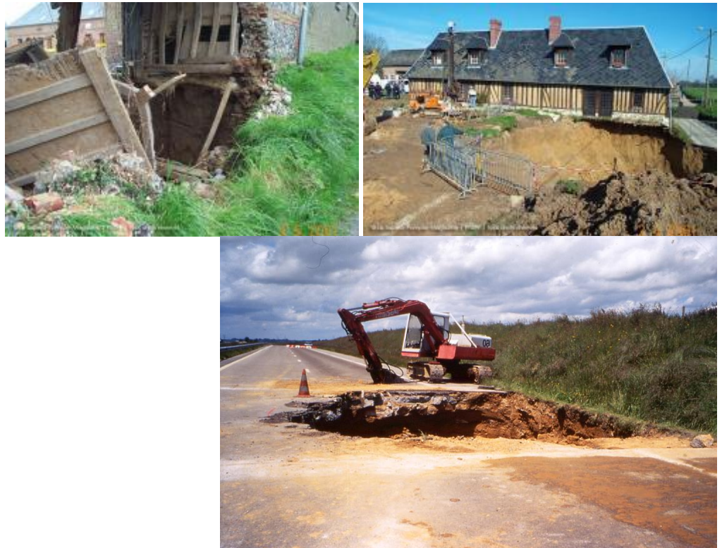
Figure 53 : Exemple de dangers liés aux cavités (source ALISE)
